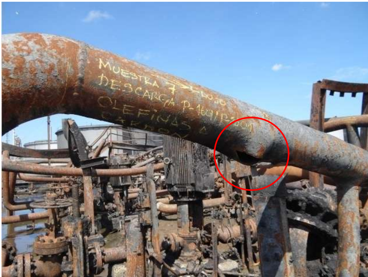
Muestra N°7. Línea de Descarga de la P-1601 /P-2601 – Olefinas a Refinería Cardón.
